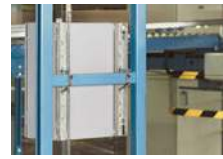
Шкаф Atlantic на горизонтальном траверсе с суппортом Кат. № 0 364 48
