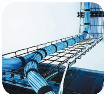
► КАБЕЛЬНАЯ ТРАССА, ПРОЛОЖЕННАЯ В ЛОТКЕ CABLOFIL ШИРИНОЙ 300 ММ
